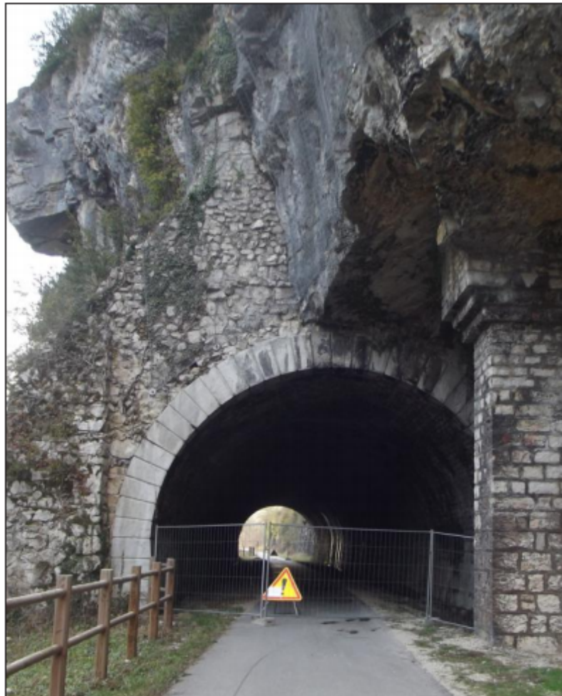
■ L'accès au tunnel complètement interdit. Photo Philippe MEULLE
